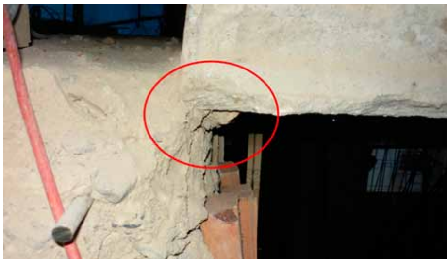
Havarijní stav předpjatých spirall panelů, uložených na cihelné zdivo
